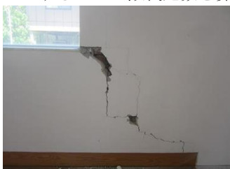
図1 開口部付近の損傷
